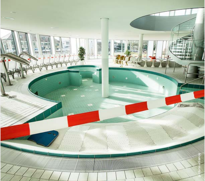
Absperrung vor dem Erlebnisbecken im sanierungsbedürftigen Hallenbad in Ismaning
